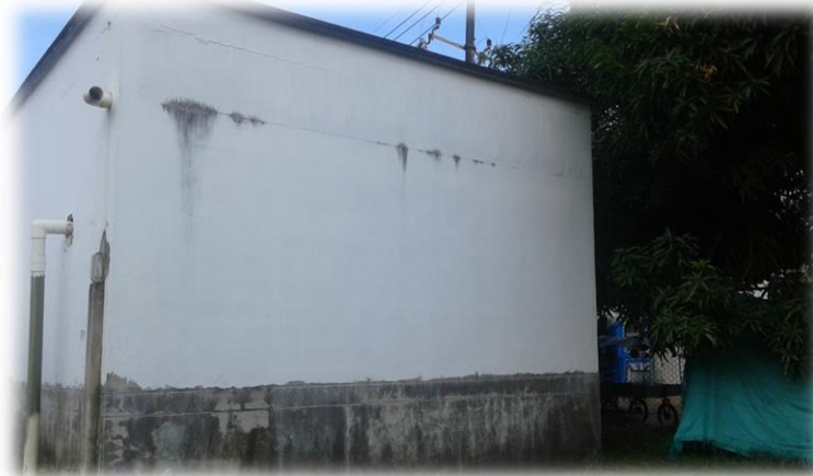
Imagen 13 Tanque subterráneo de agua
