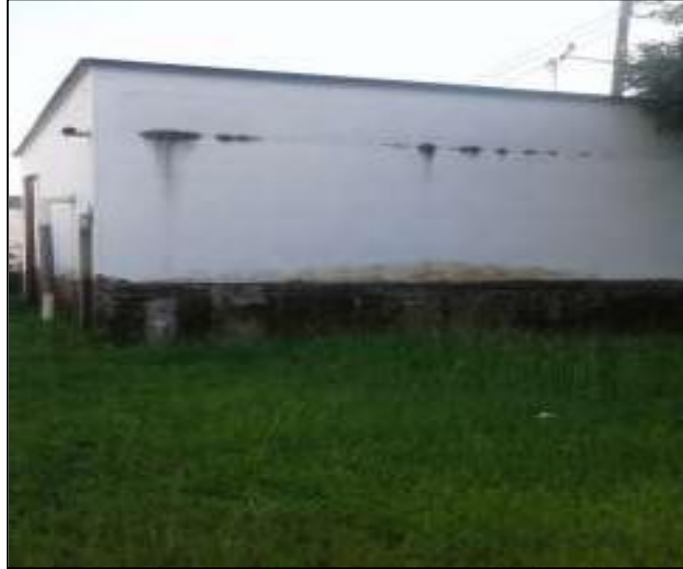
Imagen 15. Tanque subterráneo de agua
