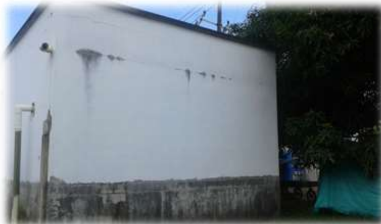
Imagen 13 Tanque subterráneo de agua
